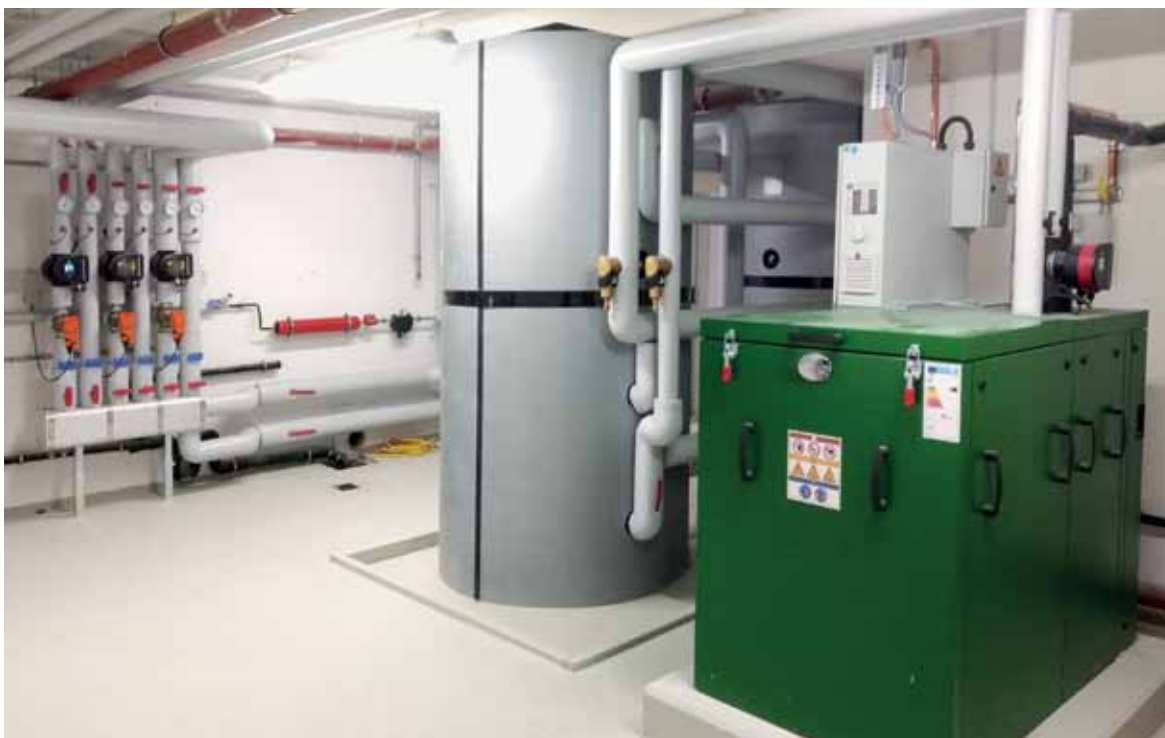
Blockheizkraftwerk, Pufferspeicher und Heizungsverteiler in der Energiezentrale des Neubaus.
